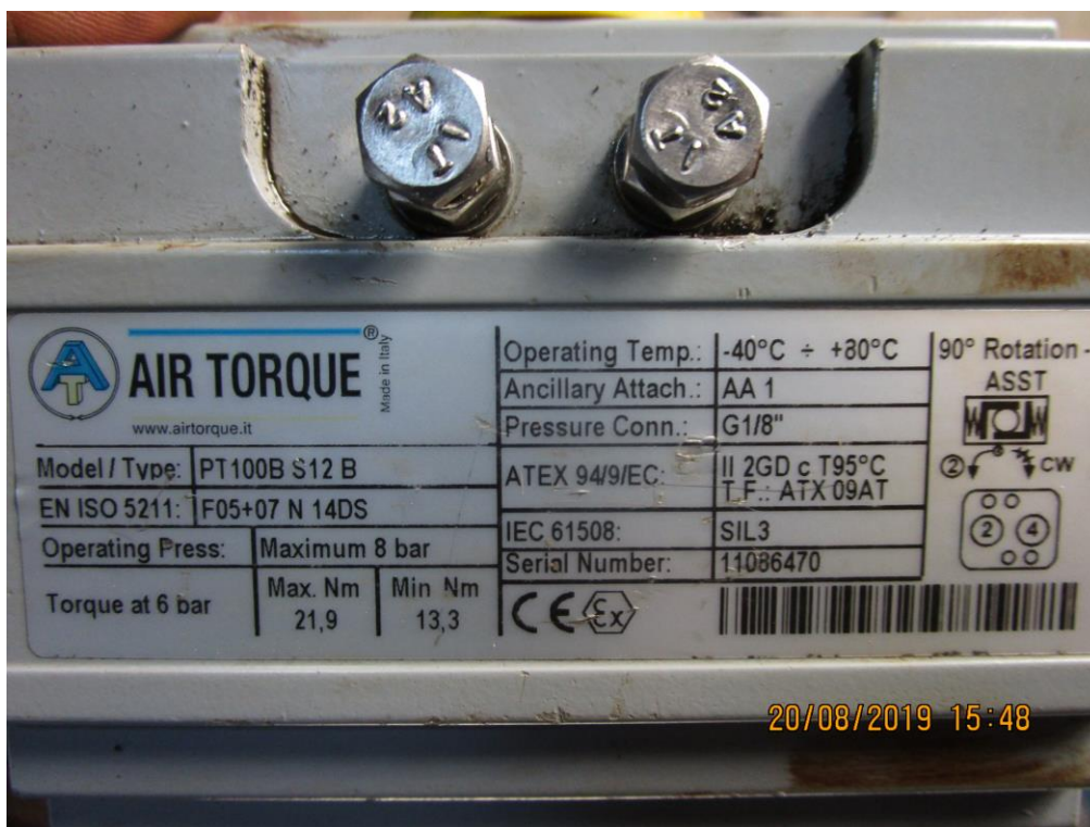
Placa de datos actuador válvula sistema de osmosis
